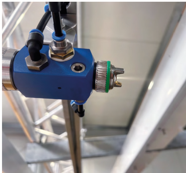
Feuchtigkeitseintrag in die Lackierkabine über die Zuluft. Beeinflusst die Farbtongenauigkeit erheblich (als Nachrüstlösung möglich).
